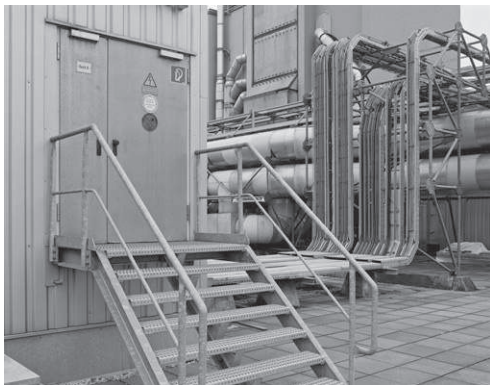
9. Aachen, Universitätsklinikum. Installationen auf dem Dach. Foto: Jürgen Gregori, LVR-ADR, 2000.
