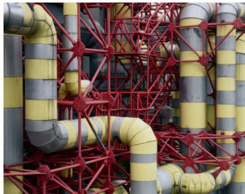
10. Universitätsklinikum. Lüftungsrohre. Foto: Jürgen Gregori, LVR-ADR, 2000.
