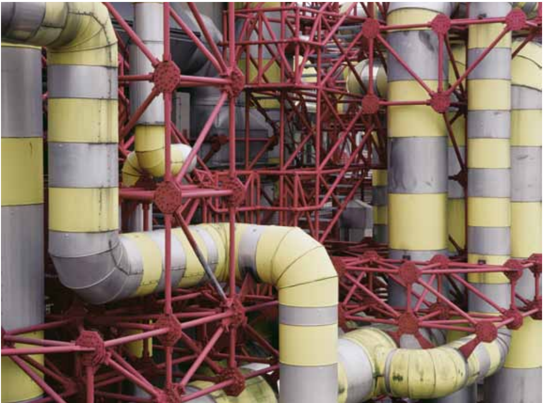
30. Aachen, Universitätsklinikum – Medizinische Fakultät der RWTH, Versorgungsrohre im Dachbereich. Photo: LVR-ADR, Jürgen Gregori, 2000.
