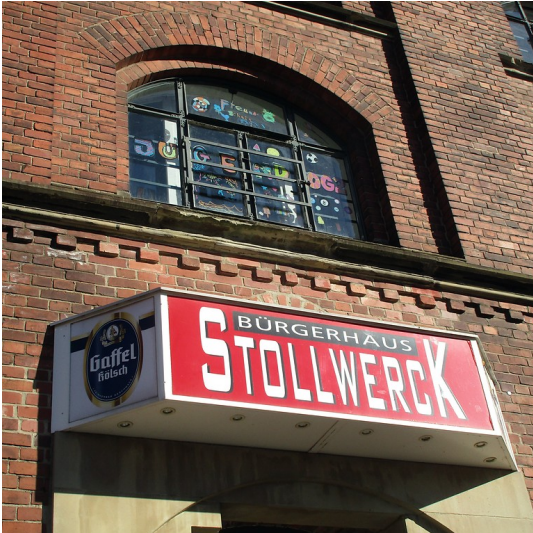
Details an der Westfassade des Bürgerzentrums "Bürgerhaus Stollwerck" in Köln-Altstadt-Süd (2019). Fotograf/Urheber: Franz-Josef Knöchel
