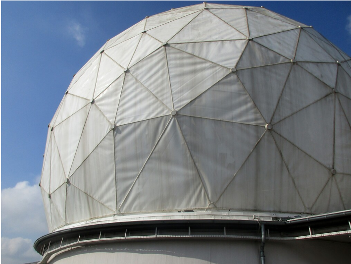
Nahaufnahme der 1985 ergänzten kuppelartigen Wetterschutzhülle für die Radaranlagen in der Mercator-Kaserne der Bundeswehr bei Euskirchen (2021). Fotograf/Urheber: Franz-Josef Knöchel
