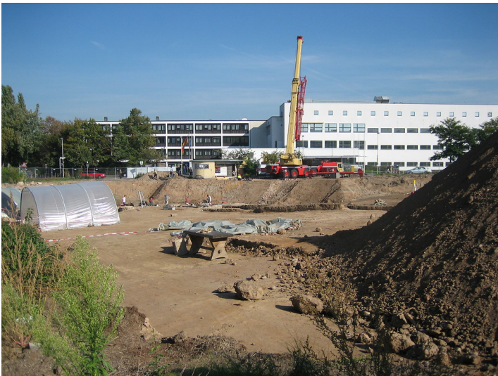
Ein Kran steht bereit, um den denkmalgeschützten Kiosk im Bonner Regierungsviertel zu verladen, um diesen zu seinem Zwischenlager, einem Bauhof in Hersel, transportieren zu können (2006).
