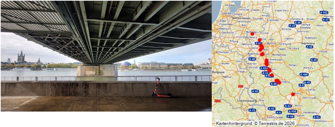
Blick von der Deutzer Rheinseite auf die Unterkonstruktion (Unterzug) der Hohenzollernbrücke (2022). Fotograf/Urheber: Franz-Josef Knöchel
