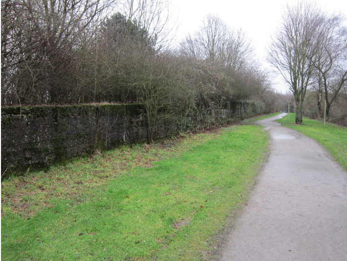
Verschiebebahnhof Bergheim (b. Moers) in Duisburg, Trompeter Straße. Mauer des ehemaligen Ablaufberges (2015) Fotograf/Urheber: Claus Weber
