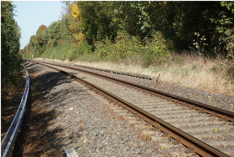
Turmbahnhof Menzelen-West, Bahnsteig der Bahnstrecke Rheinhausen - Xanten, Bahnsteigkante (2018) Fotograf/Urheber: Claus Weber
