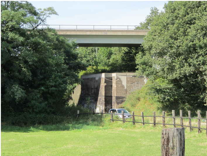
Eisenbahnbrücke bei Gerdt in Duisburg, Bahnstrecke Baerl - Geldern, Blick von Süden (2012) Fotograf/Urheber: Claus Weber
