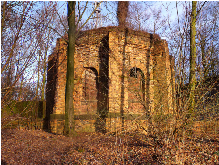
Ruine des Wasserturms auf dem Kaiserberg in Duisburg (2009). Fotograf/Urheber: Bernward Selter
