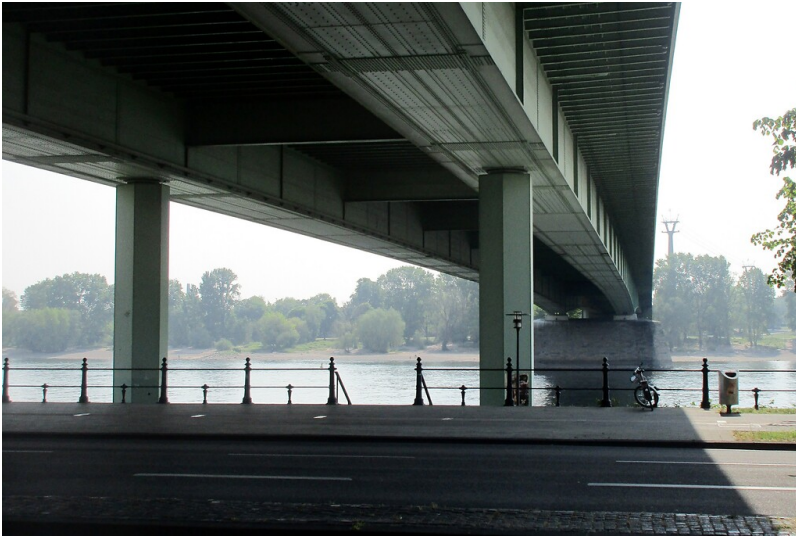
Blick vom Riehler Konrad-Adenauer-Ufer aus auf die Unterseite der Konstruktion der Kölner ZooBrücke (2020). Fotograf/Urheber: Franz-Josef Knöchel
