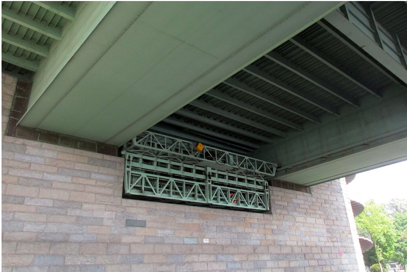
Blick vom Riehler Konrad-Adenauer-Ufer aus auf die Konstruktion des Kastenträgers der Kölner Zoo-brücke (2020). Fotograf/Urheber: Franz-Josef Knöchel
