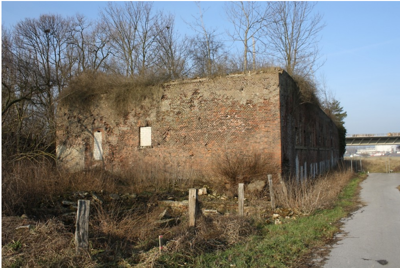
Außenansicht der Defensionskaserne des Fort Blücher bei Wesel im Januar 2009. Auf dem Dach des Ziegelbaus ist Baumbewuchs zu erkennen. Fotograf/Urheber: Biologische Station im Kreis Wesel
