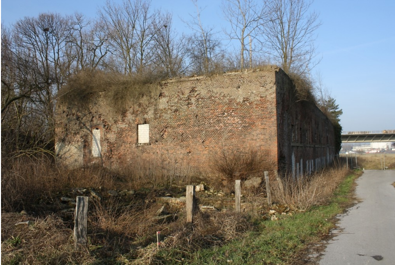
Außenansicht der Defensionskaserne des Fort Blücher bei Wesel im Januar 2009. Auf dem Dach des Ziegelbaus ist Baumbewuchs zu erkennen. Fotograf/Urheber: Biologische Station im Kreis Wesel
