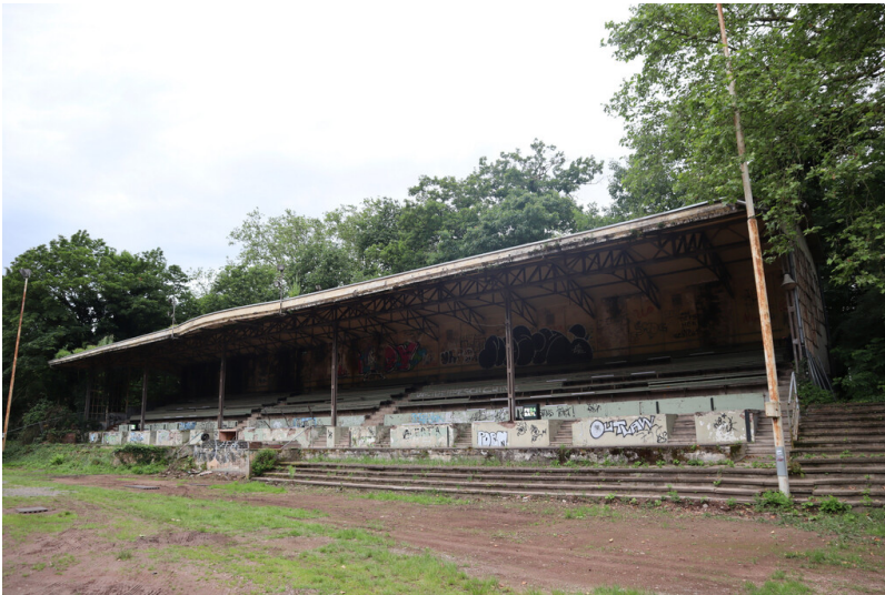
Die Tribüne des Stadions an der Rennbahn Weidenpescher Park in Köln (2024). Der fortschreitende Verfall des denkmalgeschützten Bauwerks ist deutlich sichtbar. Fotograf/Urheber: Michael Höller
