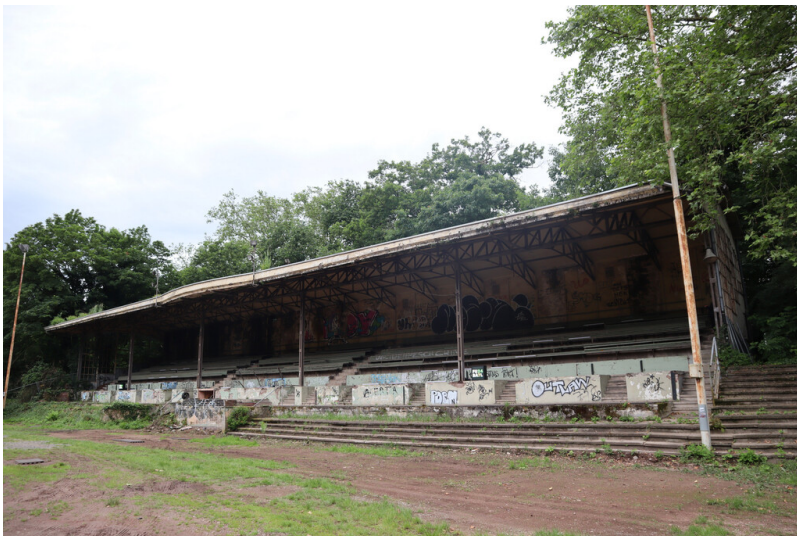
Die Tribüne des Stadions an der Rennbahn Weidenpescher Park in Köln (2024). Der fortschreitende Verfall des denkmalgeschützten Bauwerks ist deutlich sichtbar. Fotograf/Urheber: Michael Höller
