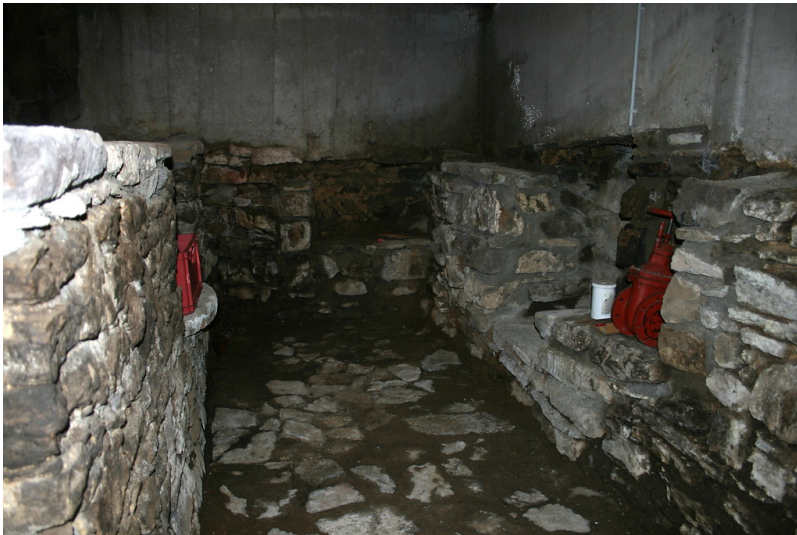
Der ehemalige Getriebekeller in der Mühle. Hier drehte sich einst die später gekappte Mühlradwelle. Fotograf/Urheber: Dr. Ralf Kreiner
