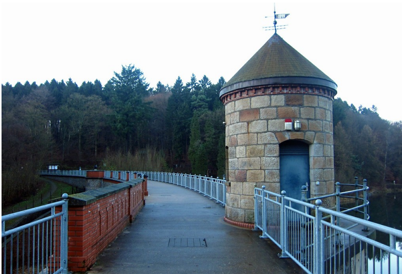
Blick über die Staumauer der Ronsdorfer Talsperre bei Wuppertal (2014). Fotograf/Urheber: Franz-Josef Knöchel
