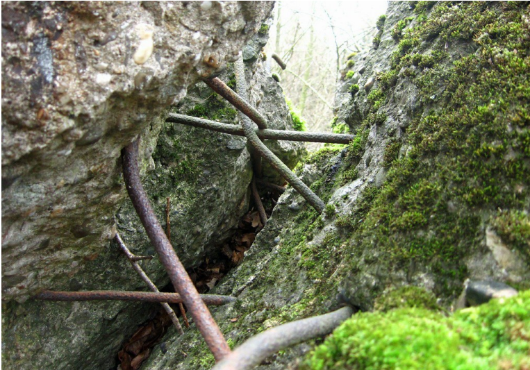
Stahlbetonreste in der Ruine des ehemaligen "Führerhauptquartiers Felsenest" bei Rodert (2012) Fotograf/Urheber: Franz-Josef Knöchel
