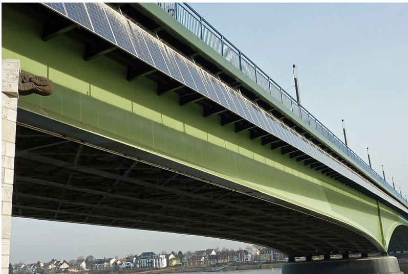
Kennedybrücke (Brückennännen und Solaranlage) (2012) Fotograf/Urheber: Schulz, Katharina
