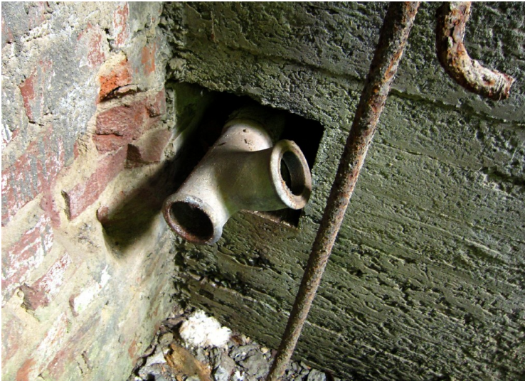
Der Reste einer Wasserleitung in der Ruine der unvollendeten Adenauervilla (2012). Fotograf/Urheber: Knöchel, Franz-Josef
