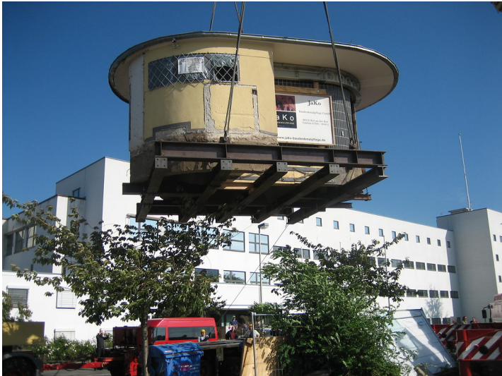
Ein Kran hebt das denkmalgeschützte "Bundesbüdchen", einen Kiosk im Bonner Regierungsviertel an, um diesen zu seinem Zwischenlager, einem Bauhof in Hersel, transportieren zu können (2006). Fotograf/Urheber: Wolfgang Schlesener
