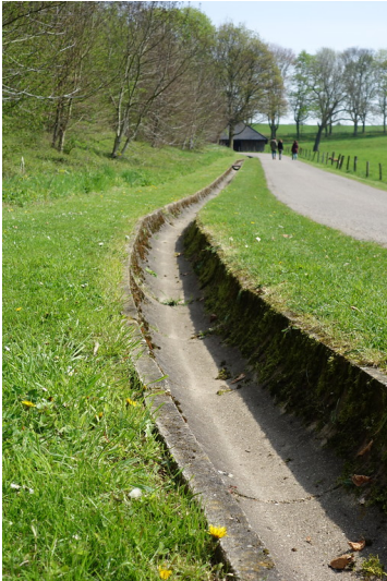
Regenwassersammelrinne am Igeler Hof (2017) Fotograf/Urheber: Martina Gelhar
