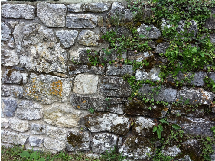
Bruchsteinmauer am Kirchhof Sand. Links vermörteltes, rechts offenfugiger Bereich. Fotograf/Urheber: Hentrich, Anne
