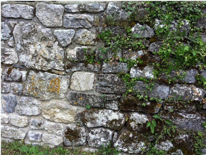
Bruchsteinmauer am Kirchhof Sand. Links vermörtelter, rechts offenfugiger Bereich. Fotograf/Urheber: Hentrich, Anne
