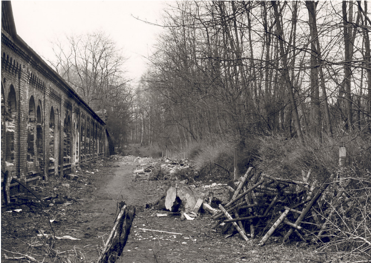
Der rechte Seitenflügel der vormaligen Fort V des äußeren Kölner Festungsringes in Müngersdorf (1962), der Graben wurde zugeschüttet. Fotograf/Urheber: Arbeitsgemeinschaft Festung Köln e.V.
