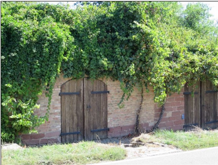
Bierkeller der Brauerei Humbert im Hang am Ortsausgang von Zeiskam (2025) Fotograf/Urheber: Peter Herzog
