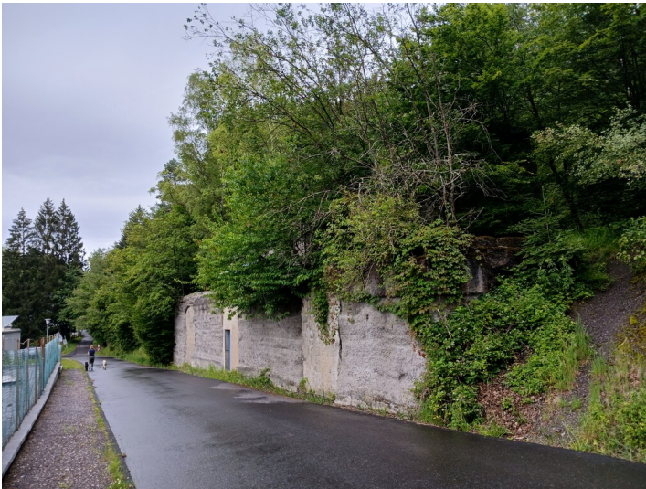
Die Ende des 19. Jahrhunderts errichtete Aufbereitung (Zerkleinerungs- und Sortieranlage) des Erzbergwerks Berzelius ruht auf Fundamenten aus massivem Stampfbeton, Ansicht von Süden (2024). Fotograf/Urheber: Alexander Kierdorf
