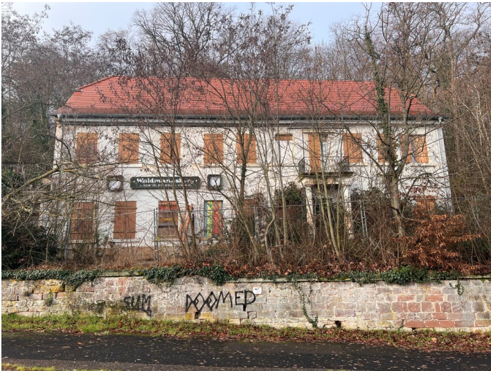
Leerstehende Waldmannsburg (2024) Fotograf/Urheber: Christine Brehm, SGD Süd
