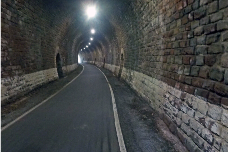
Doppeltunnel bei St Vith-Lommersweiler Fotograf/Urheber: Karl Peter Wiemer
