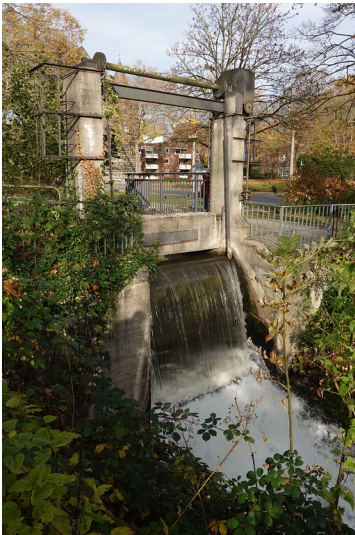
Schützenwehr Reuschenberg (2021) Fotograf/Urheber: Helmut Friedrichs
