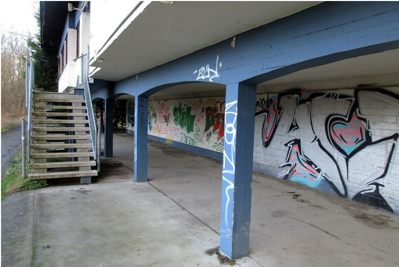
Früheres Strandbad Köln-Langel, "Verschönerungen" durch Graffiti an der nördliche Fassade des Hauptgebäudes (2022). Fotograf/Urheber: Franz-Josef Knöchel
