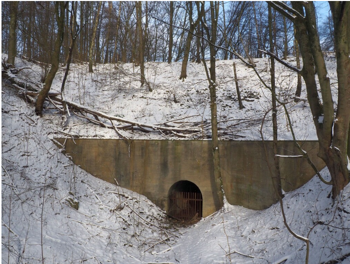
Mit einem Tunnelbauwerk versehene Einfahrt in den Bochumer Bruch (2021) Fotograf/Urheber: Jörn Kling
