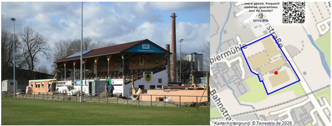
Die Tribüne der Dürener Westkampfbahn, die als die älteste Fußball-Holztribüne in Deutschland gilt (2021). Bei den Bauarbeiten werden moderne Umkleideanlagen beiderseits der Tribüne ergänzt. Fotograf/Urheber: Franz-Josef Knöchel
