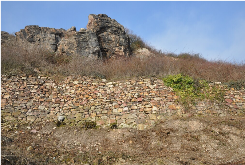
Verwilderte Terrassen im Kronnest auf Flächen des Weinguts Wegeler vor der Rekultivierung (2015) Fotograf/Urheber: Michael Burgdorf
