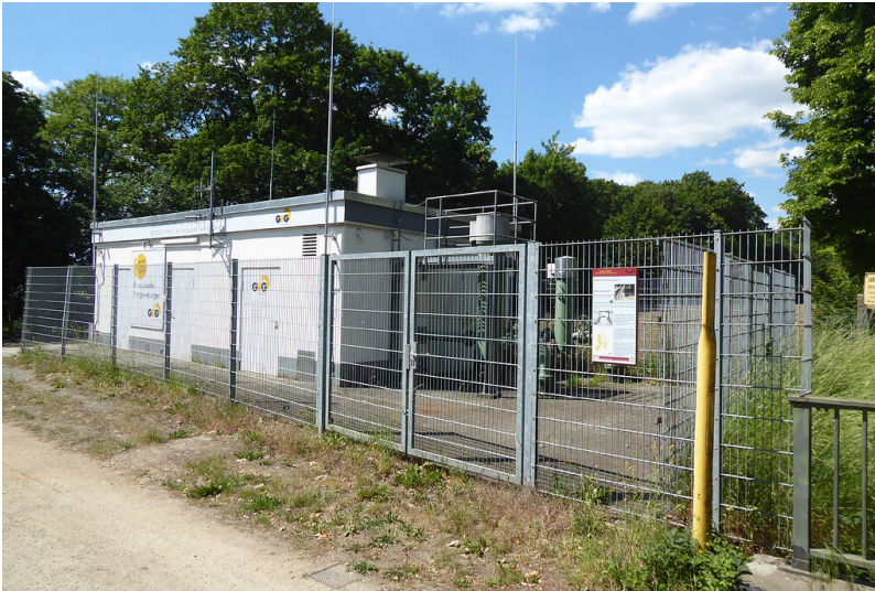
Erzählstation "Übernahmestation GVG Rhein-Erft" am Kölner Randkanal (2020) Fotograf/Urheber: Reinhard Zeese
