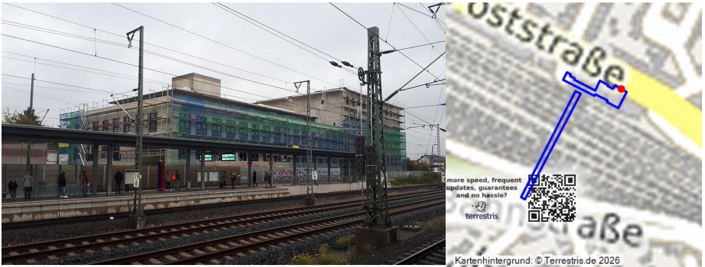
Das noch im Bau befindliche neue Bahnhofsgebäude in Troisdorf, Blick vom Bahnsteig auf den Neubau (2018).
