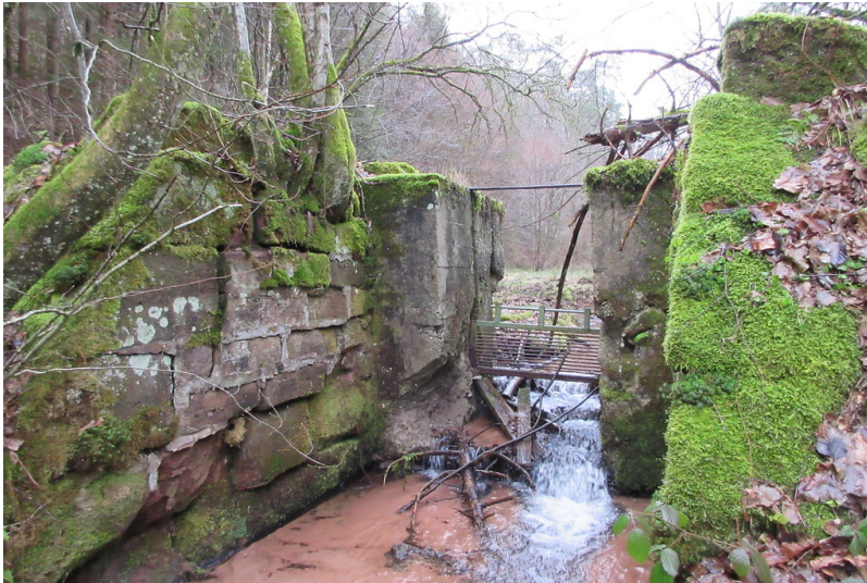
Dammdurchlass am Kaderwoog Fotograf/Urheber: Matthias Dreyer
