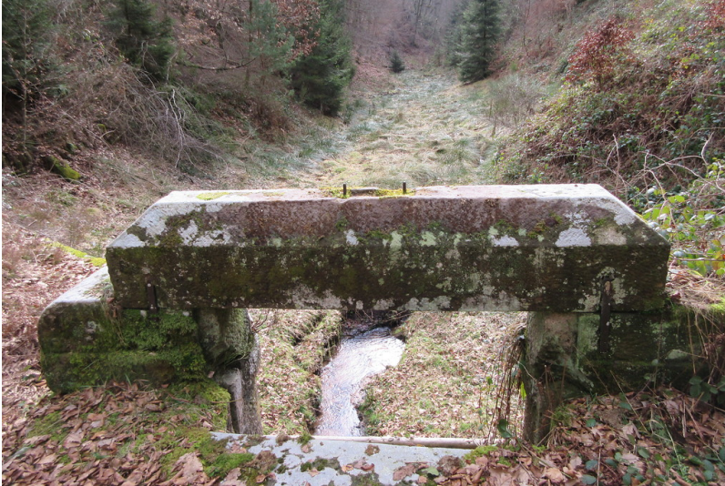
Absperr- und Auslaufbauwerk Fotograf/Urheber: Matthias Dreyer
