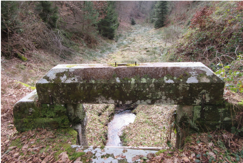
Absperr- und Auslaufbauwerk Fotograf/Urheber: Matthias Dreyer
