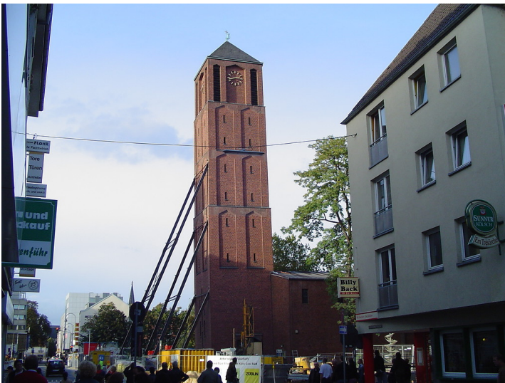
Der abgestützte Kirchturm von Sankt Johann Baptist in Köln-Altstadt-Süd (2004). Im Hintergrund das 2009 eingestürzte Historische Archiv.
