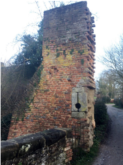
Mauern am Torbogen von Schloss Liedberg (2018) Fotograf/Urheber: Martin Sorg
