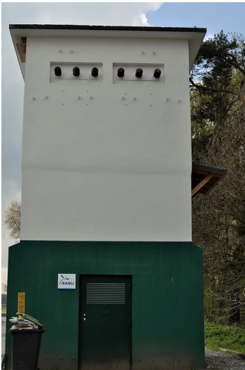
Trafoturm in Straelen-Broekhuysen (2012) Fotograf/Urheber: Monika Hertel
