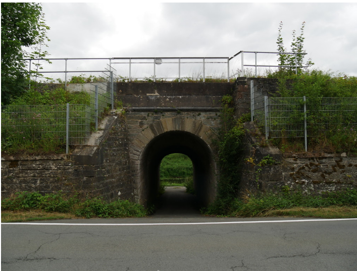
Östlicher Eingang der südlichen Unterführung zwischen der Weilstraße und der Uferstraße bei Weilburg (2017) Fotograf/Urheber: Jörn Schultheiß
