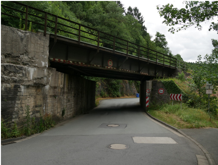
Eisenbahnbrücke über die Weilstraße in Weilburg, Blick Richtung Südosten (2017) Fotograf/Urheber: Jörn Schultheiß
