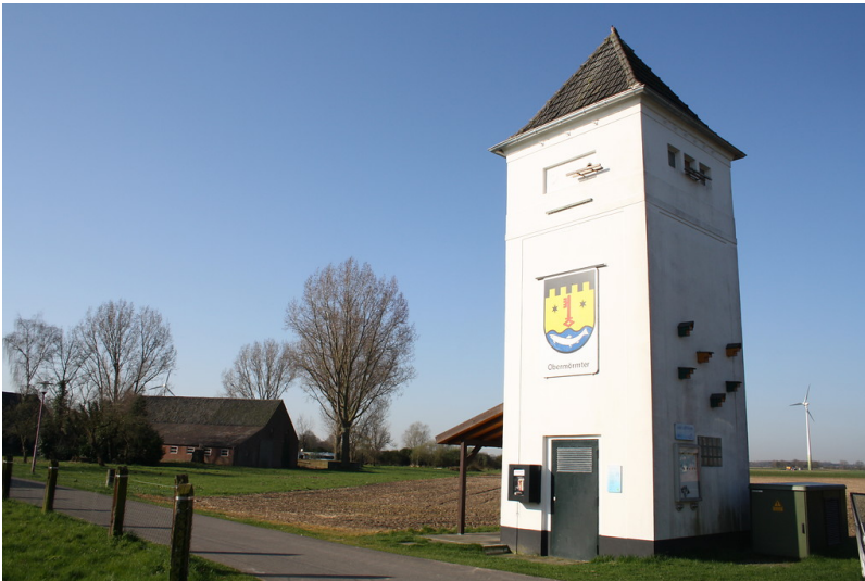
Der Trafoturm des Vereins "Obermörmter Aktiv" mit dem Wappen der Xantener Ortschaft Obermörmter am Hohen Weg (2017). Fotograf/Urheber: Johanna Siewers
