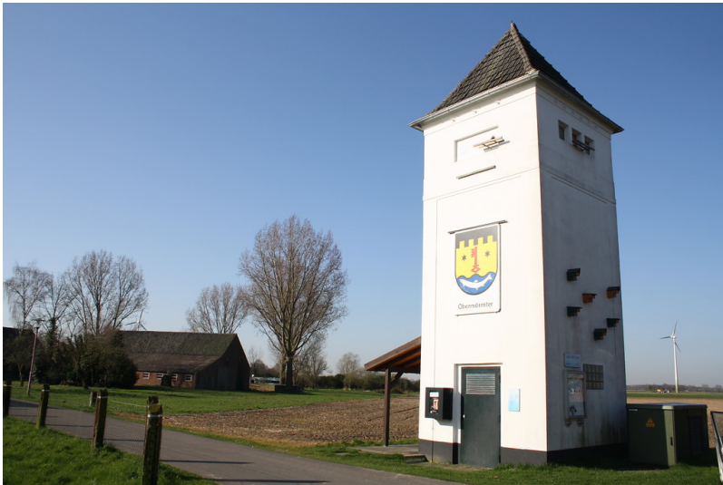
Der Trafoturm des Vereins "Obermörmter Aktiv" mit dem Wappen der Xantener Ortschaft Obermörmter am Hohen Weg (2017). Fotograf/Urheber: Johanna Siewers
