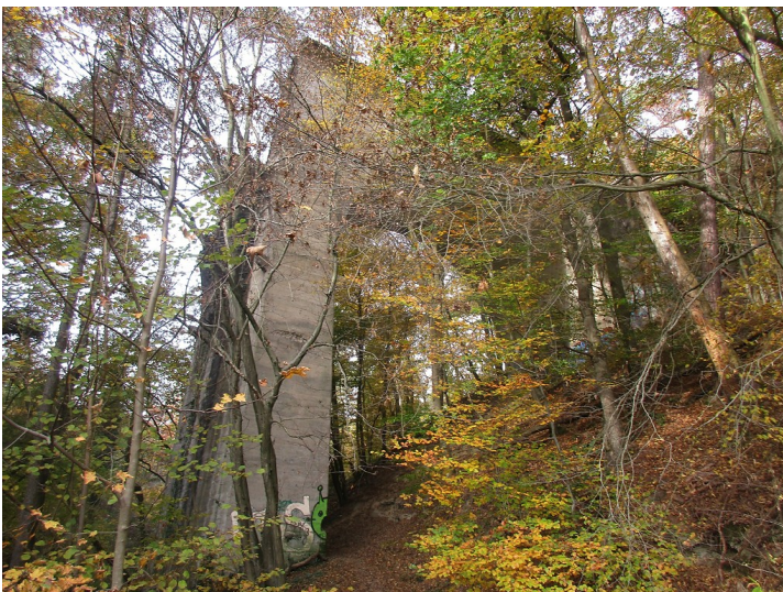
Die Ruine der Ummigstalbrücke bei Siegburg-Seligenthal (2016).
