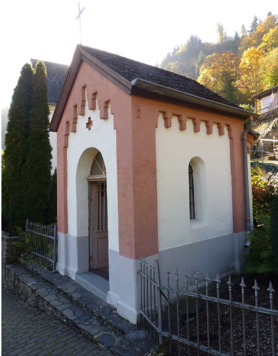
Kapelle am Kreuzweg in Oberwesel (2016): Den Start des Kreuzweges bildet eine Kapelle mit rotbraun gestrichenem Backsteinmauerwerk, die im Jahr 1850 errichtet wurde. Fotograf/Urheber: Anne Gasper
