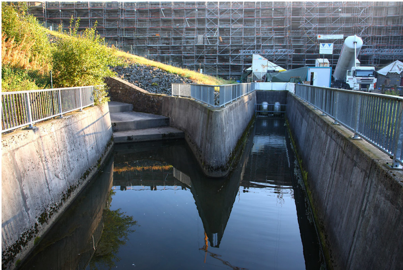
Betriebsablass der Lingesetalsperre (2008) Fotograf/Urheber: Giesen, Ulla Anne
