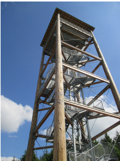
Mit vier Baumstämmen erbauter Aussichtsturm am Weißen Stein (2015) Fotograf/Urheber: Annette Schwabe
