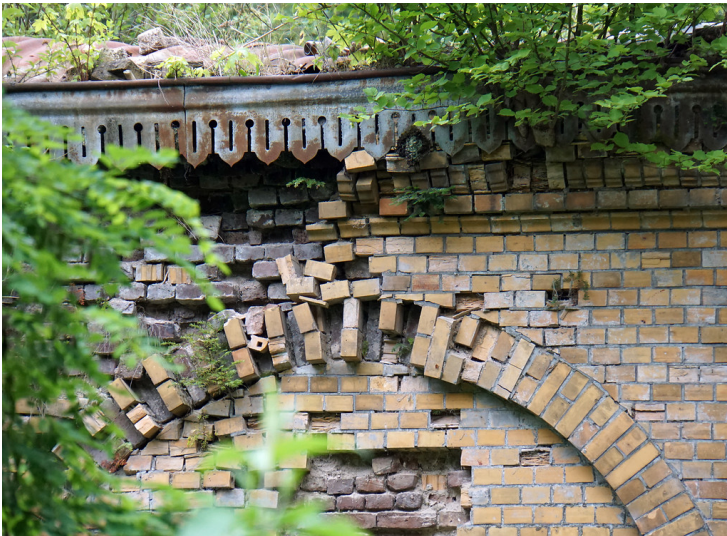
Im Verfall befindlicher Rundbogen aus Backstein in der vorderen Hausfassade der ehemaligen Villa Oppenheim (2018). Fotograf/Urheber: Florian Weber
