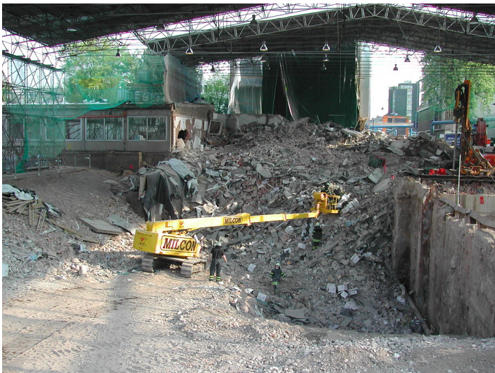
Aufräum- und Bergungsarbeiten an dem am 3. März 2009 eingestürzten Historischen Archiv der Stadt Köln (April 2009). Fotograf/Urheber: Franz-Josef Knöchel
